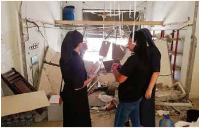
Das zerstörte Kinderheim St. Charles der Barmherzigen Schwestern im Beirut Stadtteil Achrafieh.
